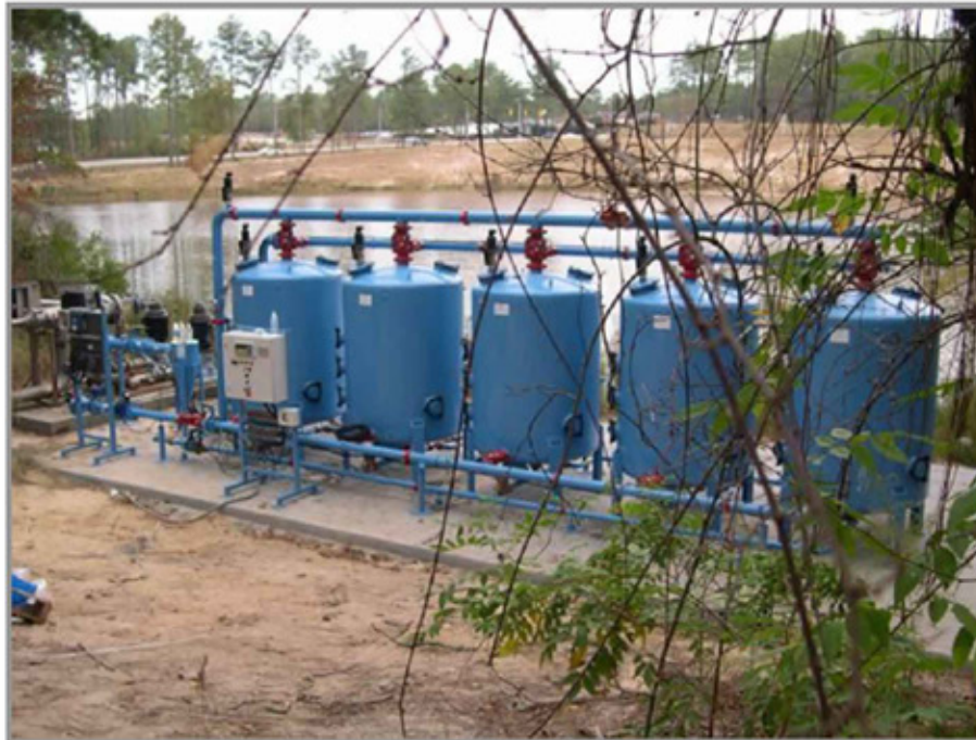
Sistema de Potabilización de Agua para remoción de Hierro Capacidad 45 m 3 /h
